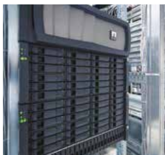
Centros de telecomunicaciones
