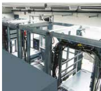
Salas de servidores
